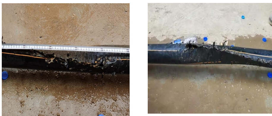
图二 管道破损图
